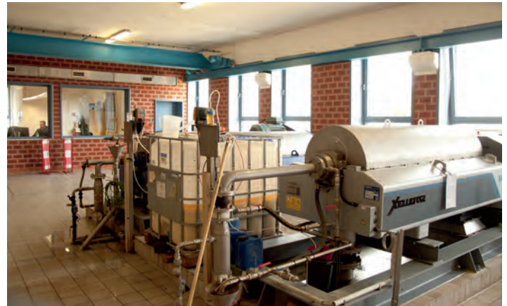
Kläranlage Stralsund Dekanter
